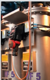
Automatic backwash filters/ Automatische Rückspülfilter
